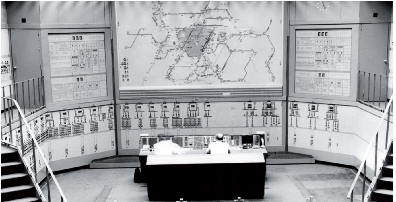
FIGURE 1.9 – Dispatching fin des années 70. On y voit les synoptiques de télécontrôle des sous-stations sur les murs (source : STIB-MIVB)
