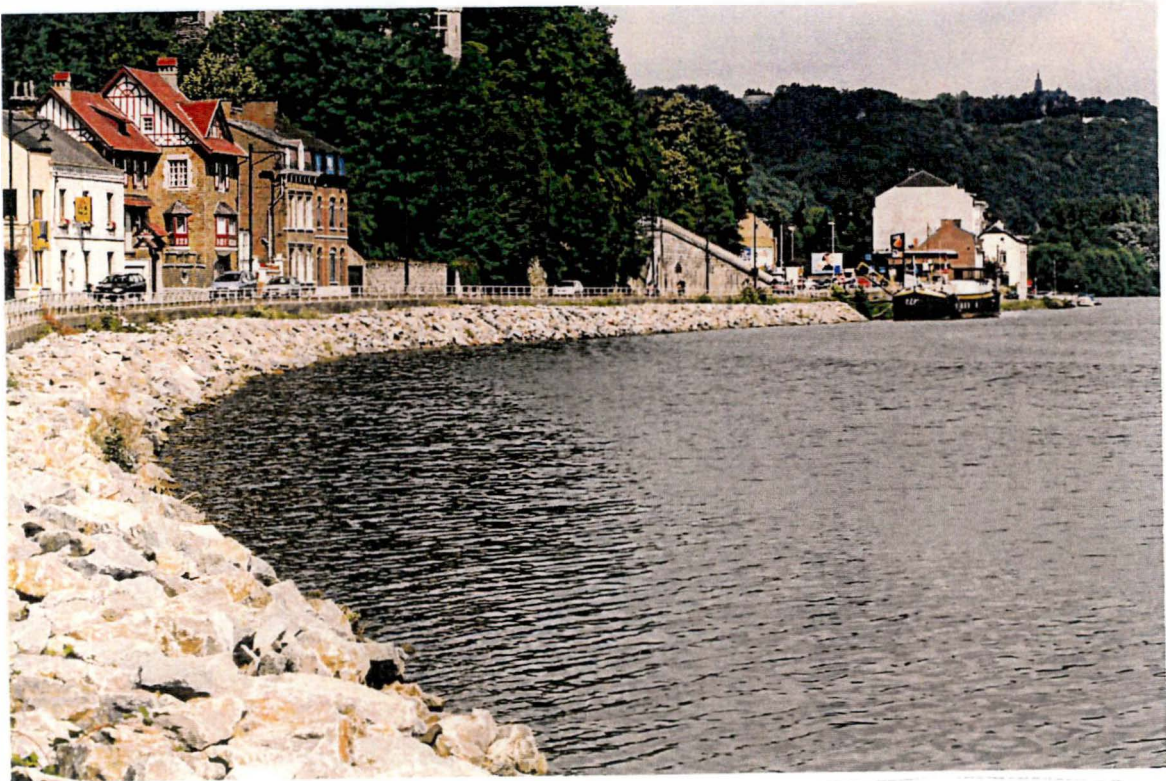
Photo 8 : Berge artificielle, enrochement de gros blocs de pierres, sans végétation ni abris au contact de l'eau.
