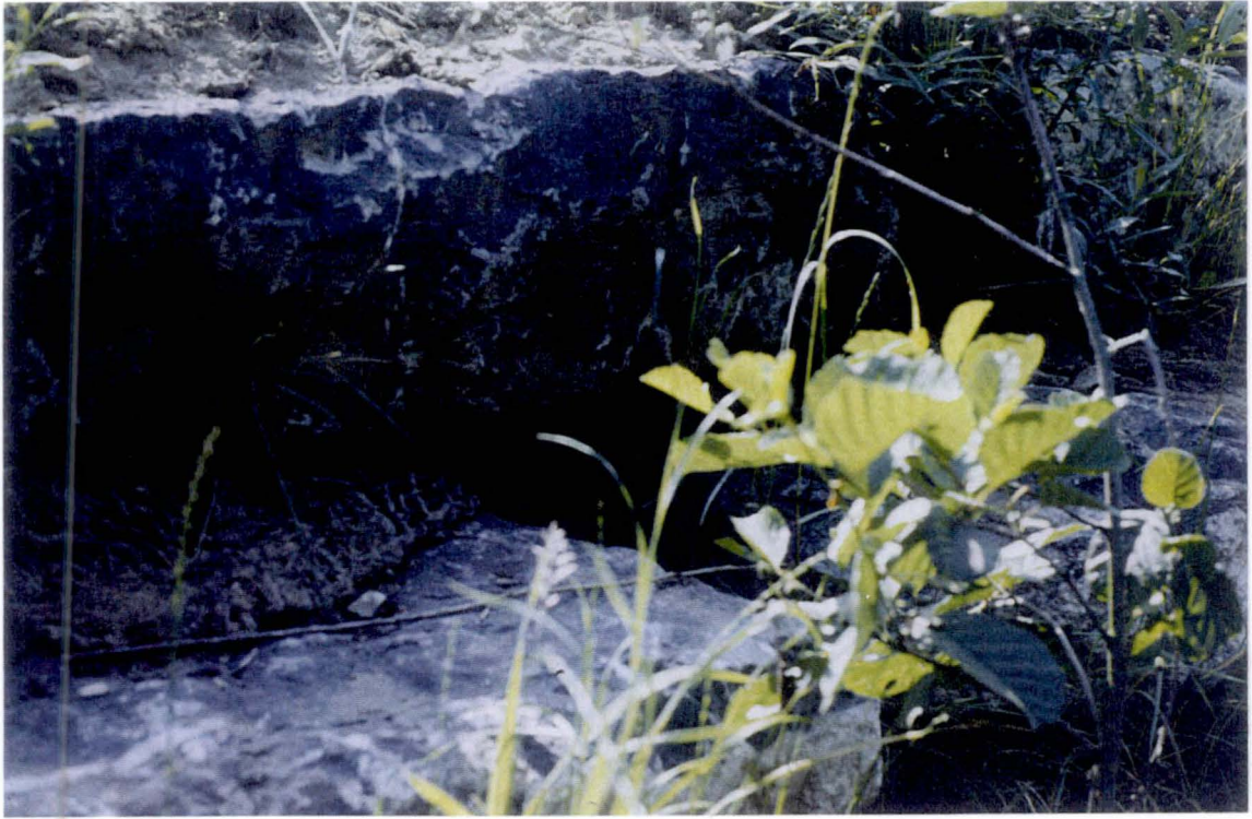
Figure 34 : Photo montrant l'érosion entre les blocs de pierres du premier sous-secteur à Furfooz (printemps 1997).
